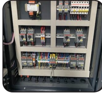
CE Standartlarında Güç ve Kontrol Panosu Power and Control Panel with CE 2006/95/EC Standards
