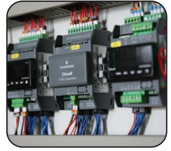
CE Standartlarında Güç ve Kontrol Panosu Power and Control Panel with CE 2006/95/EC Standards
